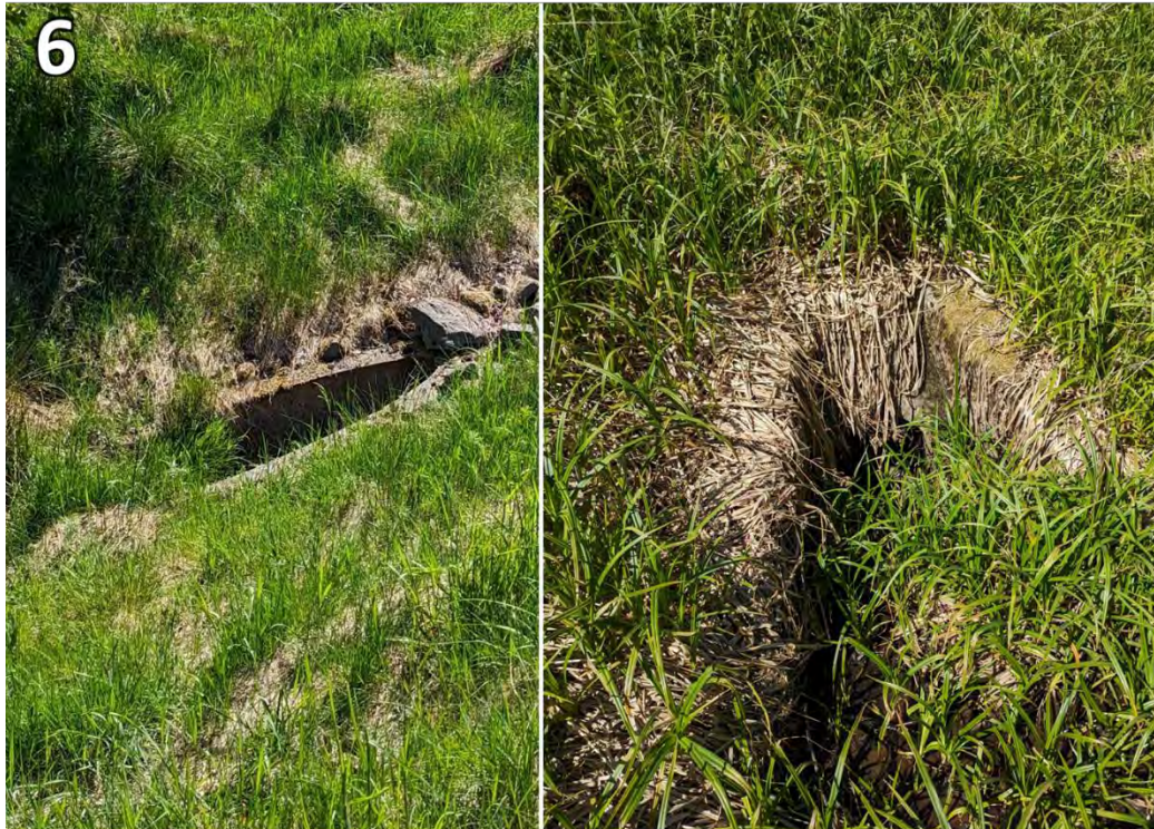
Figur 54. In- och utlopp, befintlig dagvattenkylvert (400 mm) som leder till dikessystem förbi Råvebergsvägens norra damm (Foton: Petter Mogenfelt)
