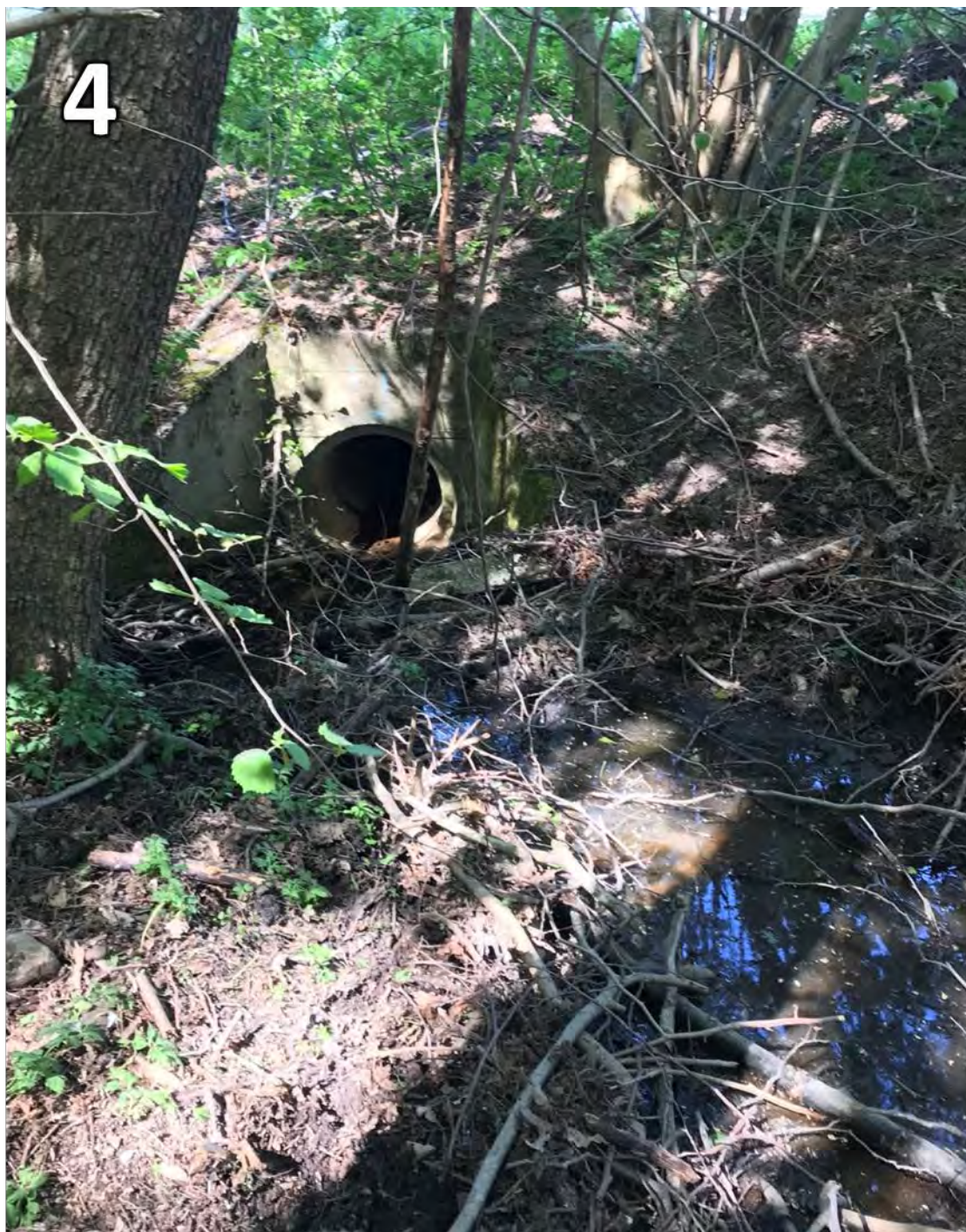
Figur 60. Inlopp till kulvert (500 mm) under Råvebergsvägen, bild tagen från vägens sydvästra sida (Foto: Adam Santesson)
